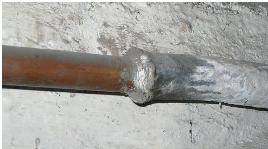
Noch immer in Altbauten zu finden: Bleirohr (rechtes Stück) für die Trinkwasserversorgung. © KBreker
